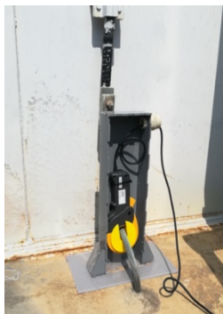
写真 1 変圧器の接地線に取り付けられたクランプ型電流センサー
