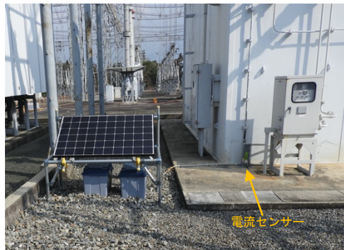
写真 2 変圧器そばに接地した太陽電池パネルと計測機器・ロガー収納箱
